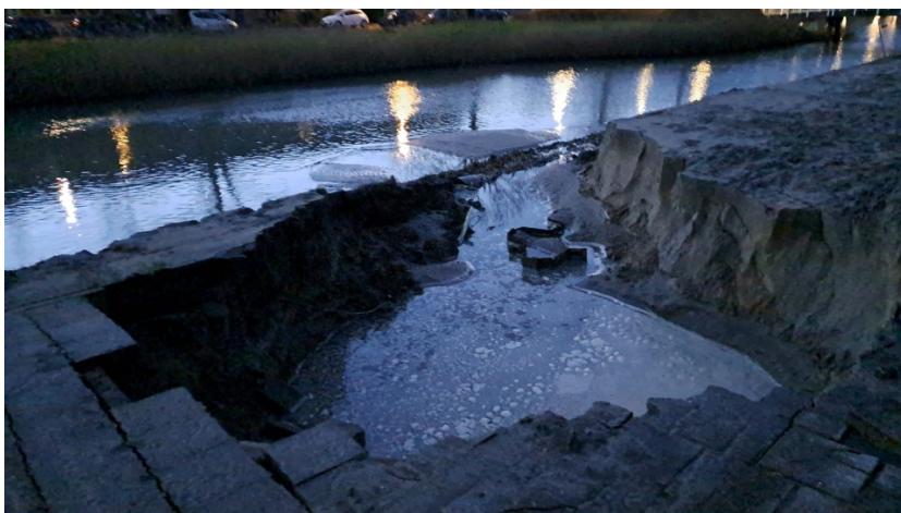
Figuur 1: schade door recente breuk Waterwolfpad
