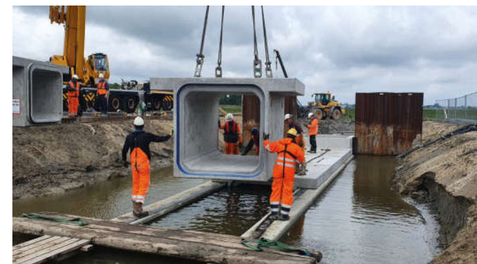
figuur 14: een kijkje in de uitlaatconstructie
