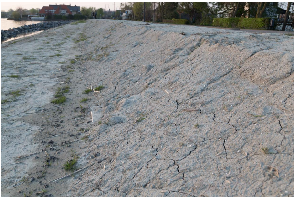
Erosie aan de waterkant van het dijklichaam veroorzaakt door buiswater van de keiendam
